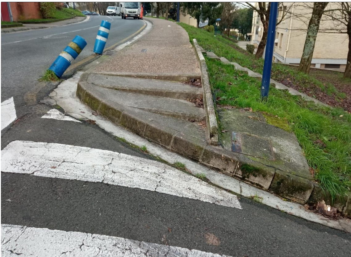
El paso no está rebajado y el acceso es a unas escaleras que no cumplen accesibilidad en Versalles
