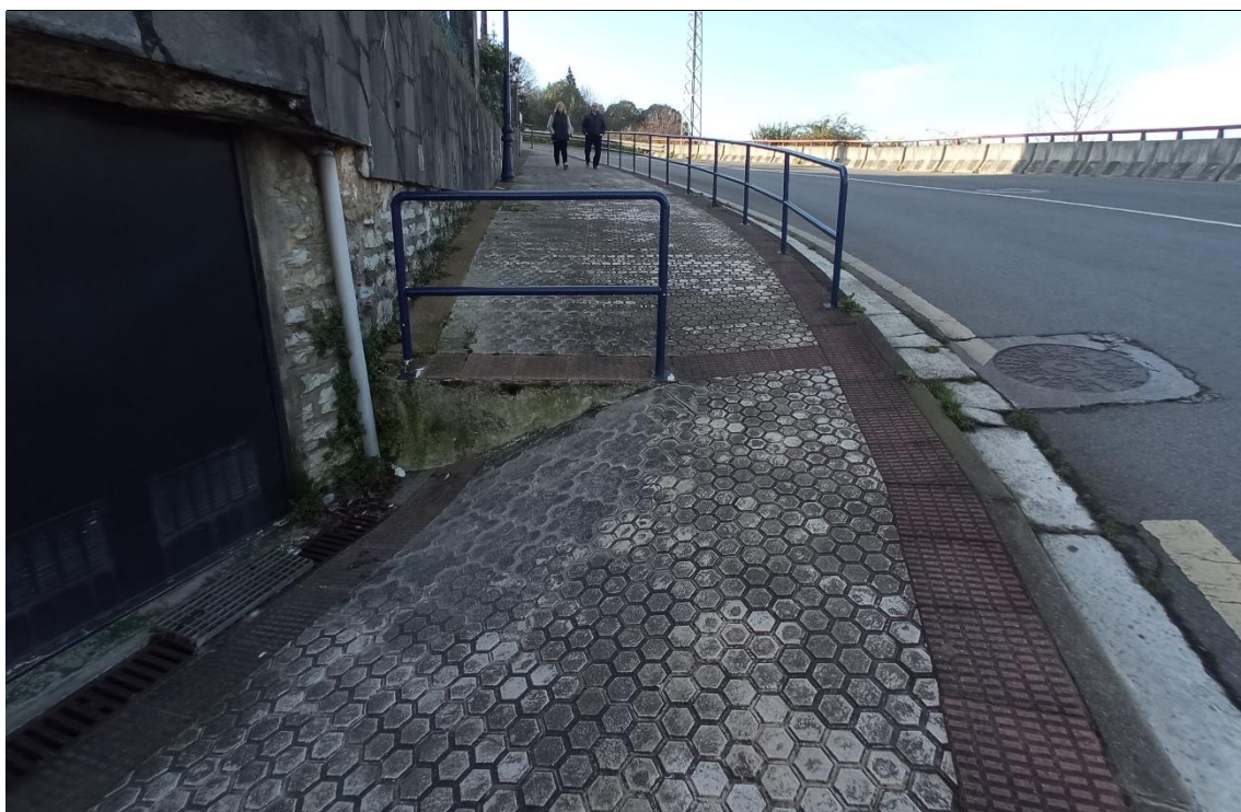
Gran pendiente longitudinal y transversal en la entrada a garajes en Capuchinos
