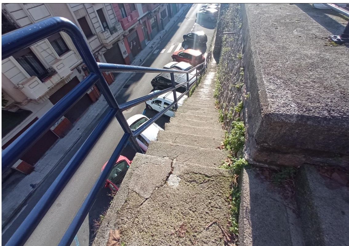
Escaleras estrechas y con necesidad de barandilla anticaída en Nafarroa con Amasas
