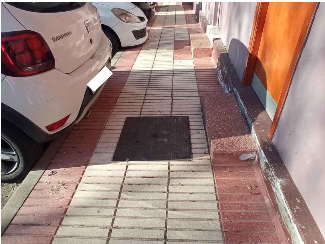
Julian Lavilla kalea. Las aceras se estrechan además de por el mobiliario urbano por la presencia de escalones de acceso a portales
