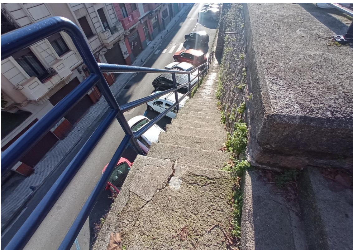
Eskailera estuak eta drogen aurkako baranda Nafarroan Amasasasekin
