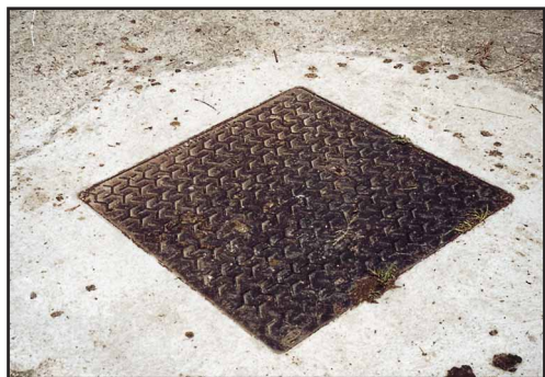
M-30 Caserío Zamora (dentro de la arqueta)
