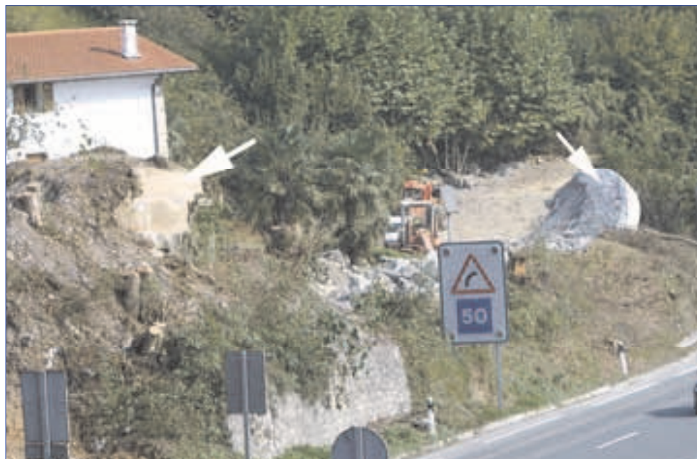
Fig. 25: Gaintxurizketa: Obra n. 4 durante la demolición. Puede apreciarse su situación con relación a la carretera N-1 y al caserío "Kamio-txiki".
