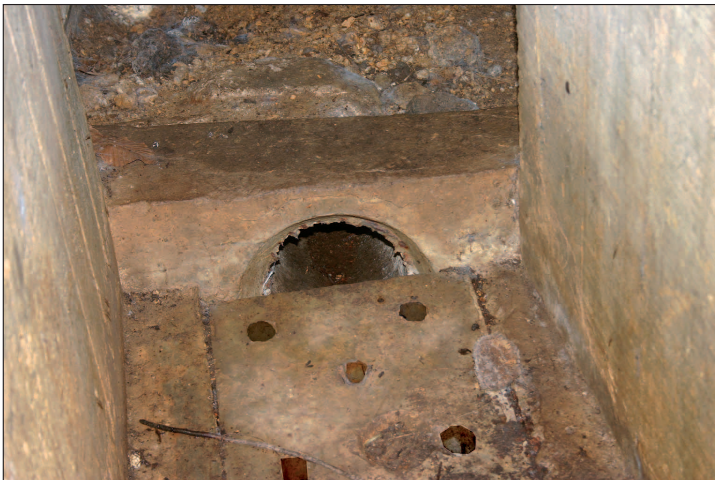
Fig. 9: Sumidero para el drenaje de las galerías. Normalmente se encuentran a la entrada de nidos y refugios. El de la fotografía corresponde a la obra n. 2.
