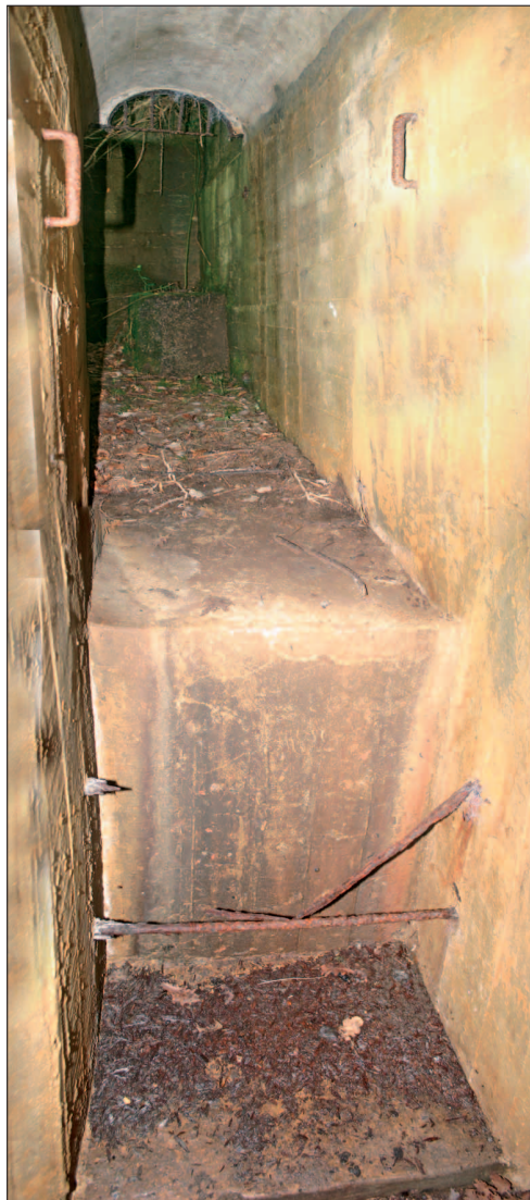
Fig. 25: Obra n. 3. Acceso al pozo para tirador (Fig. 22, letra J). Presenta una diferencia de cota de aprox. 1 m. que se salva mediante dos escalones formados por ferralla. Nótese también los dos asideros para ayudar a salvar los escalones.
