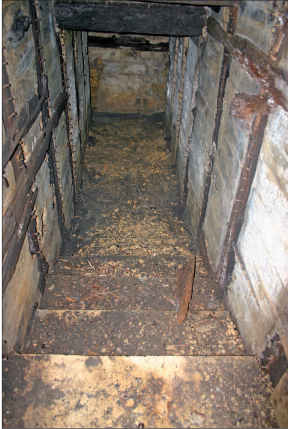
Fig. 20: Almacén de munición de la obra n. 2, visto desde su acceso. Mantenía el encofrado, pero actualmente está quemado, pudiendo observarse los clavos que salen de la madera chamuscada.
