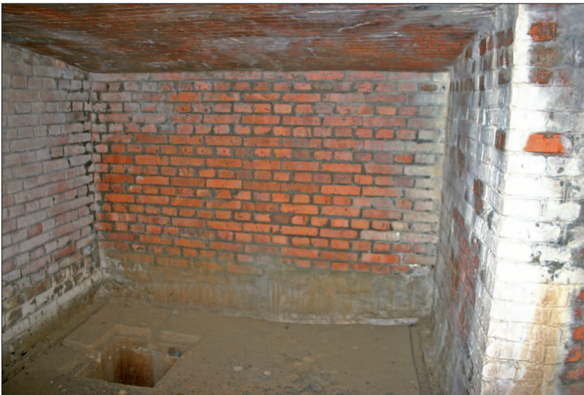
Fig. 50: Obra 25. Interior del depósito de munición. Está totalmente revestido de ladrillo, incluso una bóveda extremadamente rebajada (casi es un techo adintelado). En el suelo se aprecia el sistema de drenaje hidráulico, formado por canalillos que desembocan en un registro.
