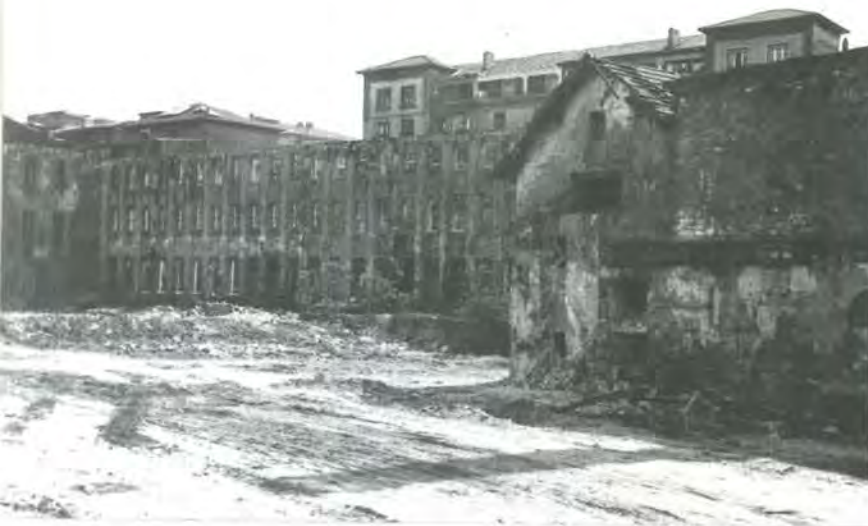
Derribo parcial de la fábrica de Tejidos de Lino. Junio 1981. Foto: AMR.
